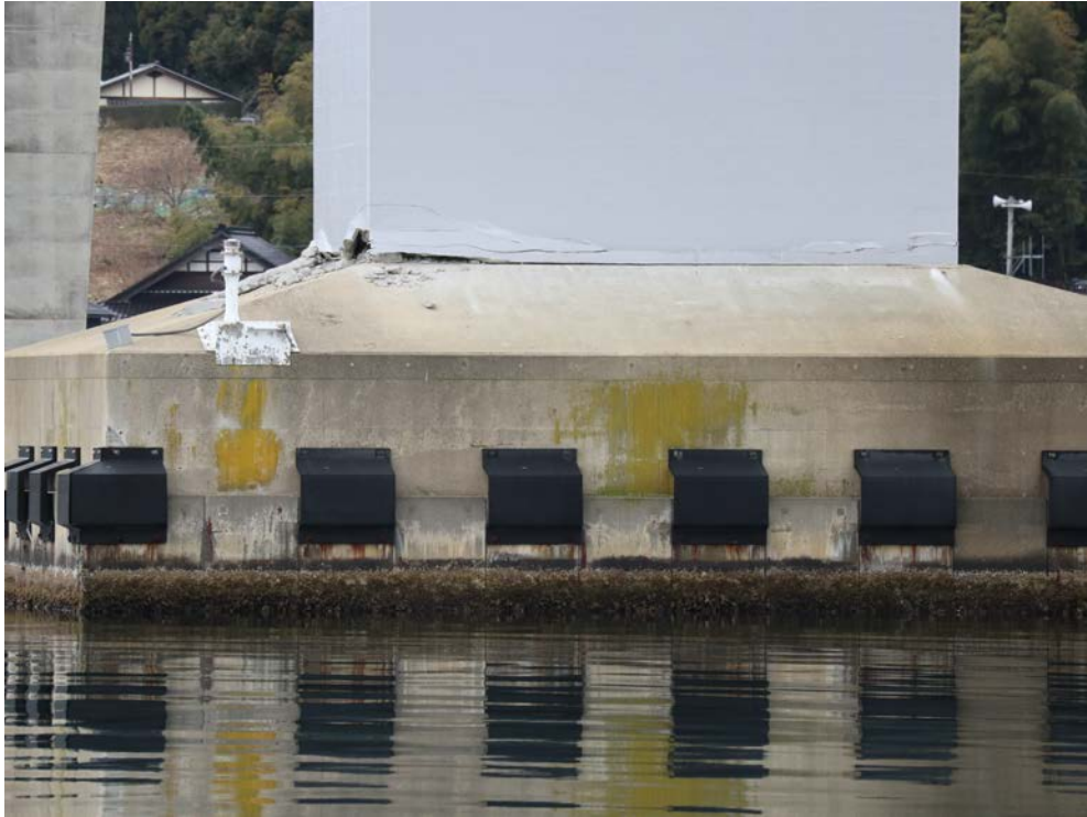
写真9 P3 橋脚基部の曲げ破壊（連続繊維シートの破断を伴う）
