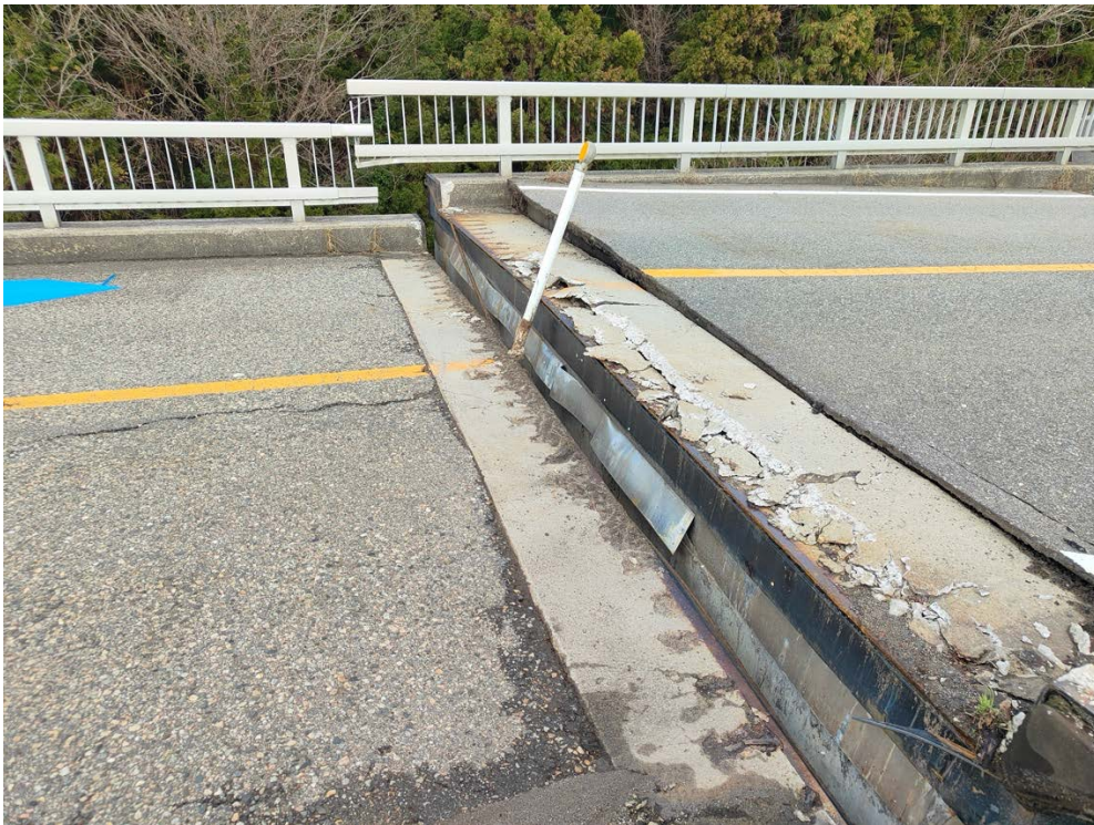
写真10 能登島側橋台に生じた路面段差（左側が橋梁上部工で右側が橋台および背面、約40cmの段差が生じている。）
