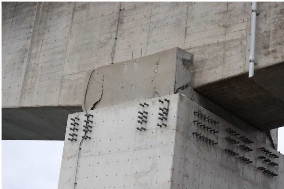
写真8 P4橋脚における沓隠しの損傷
