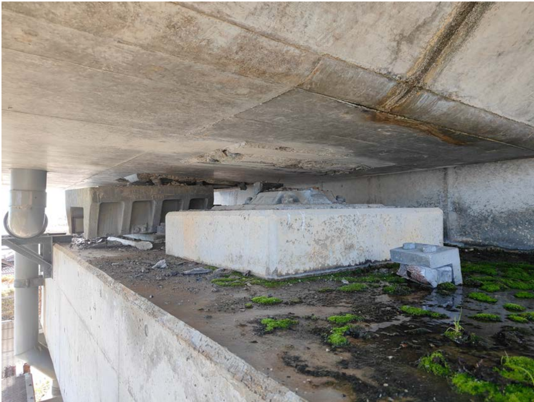
写真7 A1橋台（能登中島側）での支承の脱落
