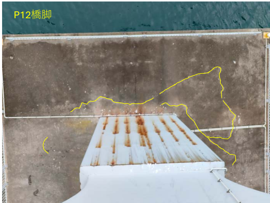
写真3 P12 橋脚のフーチング上面のひび割れ
