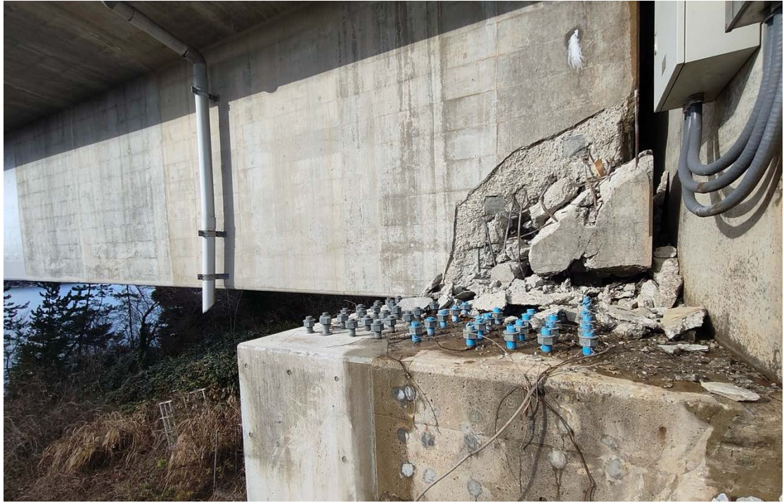
写真11 能登島側橋台の支承部の損傷状況（支承部のコンクリートが破壊し、支承が埋まっている。）
