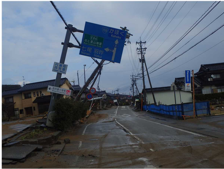
地盤の隆起・電柱の倒壊、道路（舗装）の損傷（内灘町西荒屋地区）
