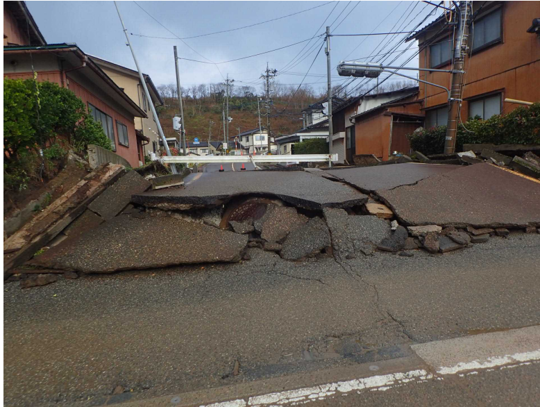
地盤の隆起によって道路が寸断
