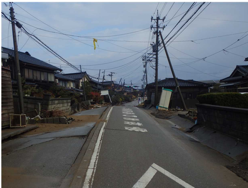
地盤の隆起・道路（舗装）の損傷（内灘町西荒屋地区）
